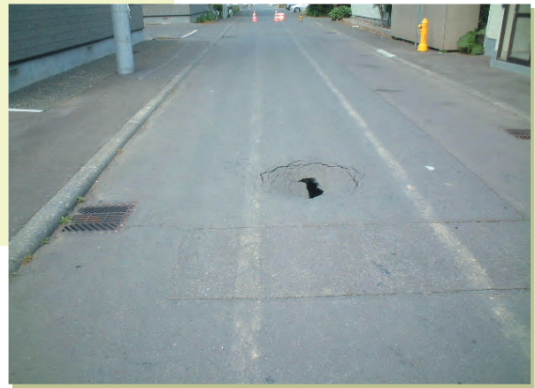
道路の陥没 [提供:札幌市]
