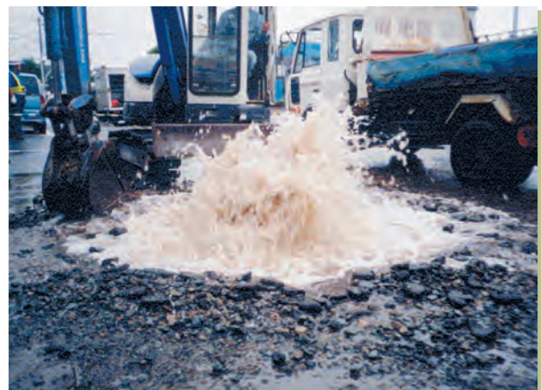
破裂した上水管 [提供:札幌市]
