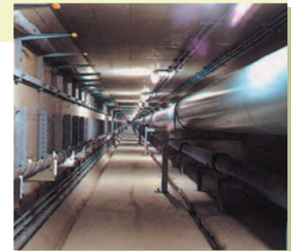
◆共同溝 [提供:札幌市]
