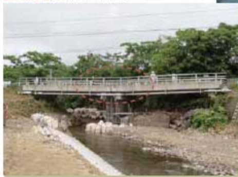
変状した橋梁 [提供:北海道開発局]
