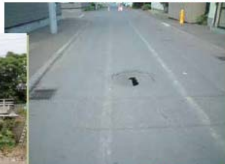
道路の陥没 [提供:札幌市]
