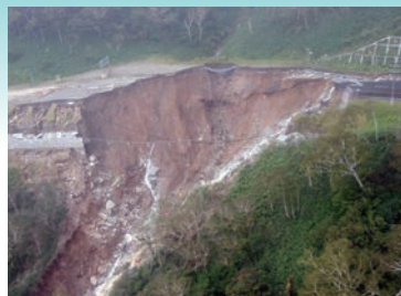
日勝峠7合目の盛土崩壊
