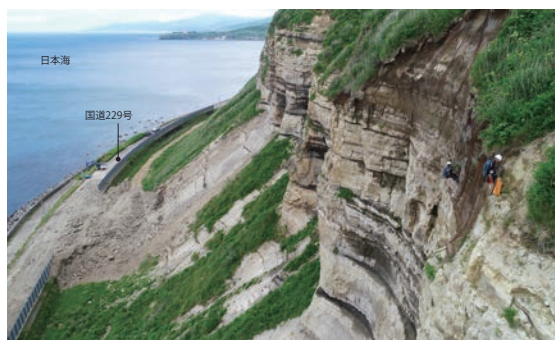
一般国道229号乙部町館浦 土砂崩壊による国道の被災(2021年6月)
